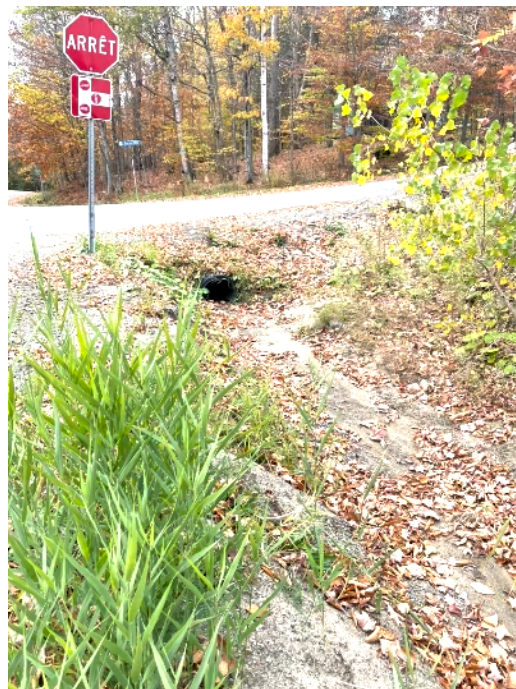
Exemple de fossé instable (coin de Forest Hill et Lakeshore), montrant l'accumulation de sédiments et l'implantation d'une espèce végétale envahissante (phragmites).
